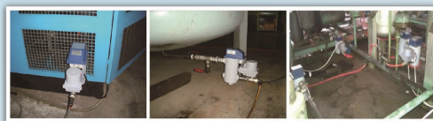
安裝於空氣桶與冷凍乾燥機
