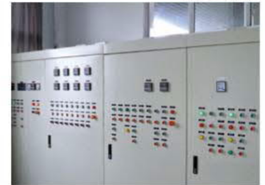
■機電控制設備
