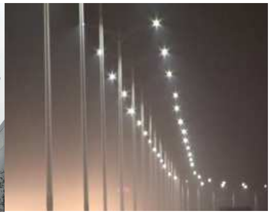
廣東恩平 325 國道安裝 120W 路燈
